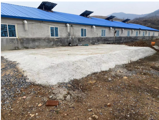
地下污水暂存池
