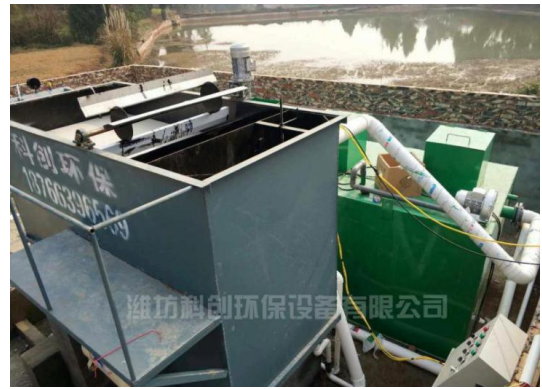
污水处理一体化设施
